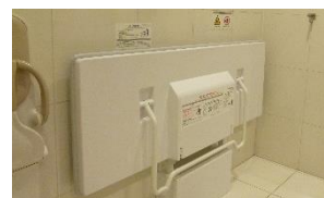
介護シーンでも役立つ多目的トイレの収納式多目的シート
